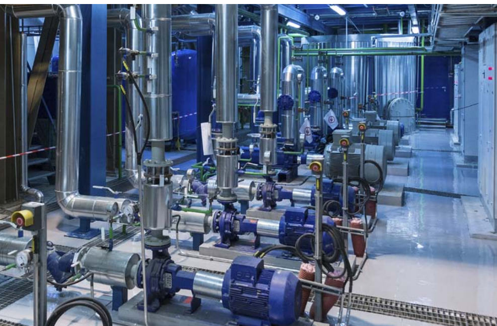
Применение для насосов (например, экономия энергии в автоматике зданий с преобразователями частоты)
